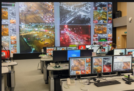
Centrum monitorowania ruchu drogowego w Rijadzie
